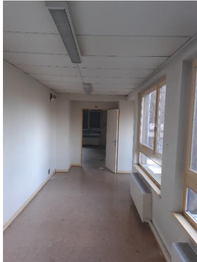
Illustration 1 : Couloir désaffecté d'un bâtiment visé par les travaux de démolition, ECOLOR le 04 mars 2021
