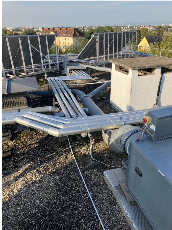
Illustration 10 : Vue de systèmes de chauffage et de panneaux solaires sur le toit n°21 rue Ampère - Source ARCHIMED Environnement
