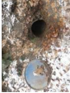
Dans certains cas, un ancien baril suffit pour consolider l'entrée d'une cavité.
