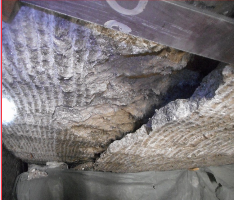
Deformierte und zerstörte Hangendstrukturen
