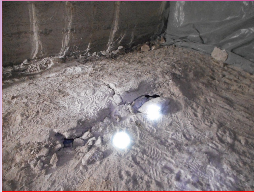
Risse und Brüche in der Sohle
