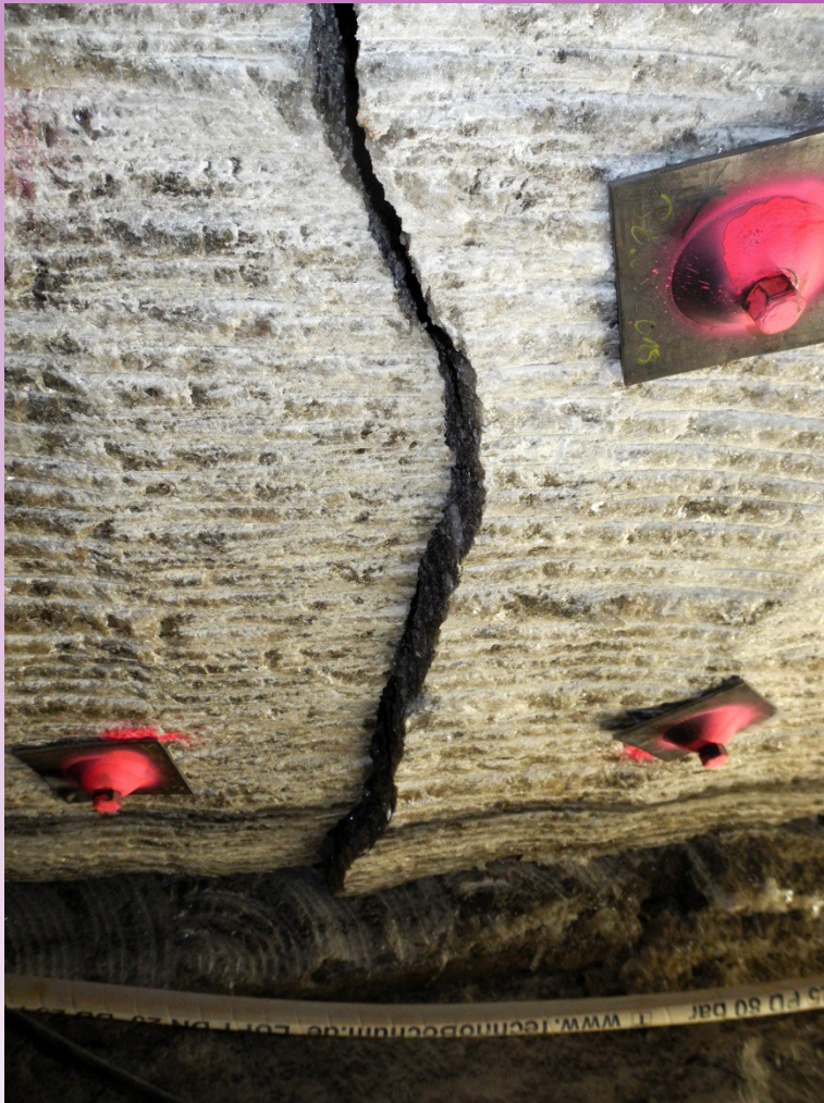
Trennbruch im Hangenden
