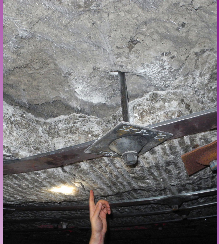
Scherbruch im Hangenden
