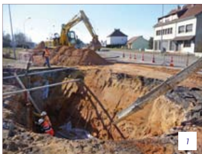
1 - 2 : Dommages miniers pris en charge dans le bassin houiller Lorrain (Source BRGM)
