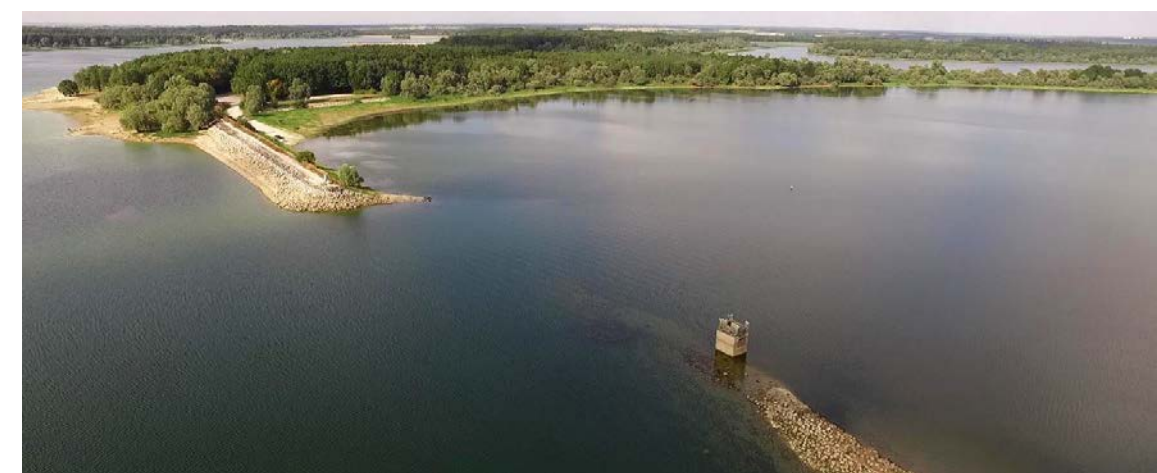
Figure 41: Brèche dans la digue de Champaubert
