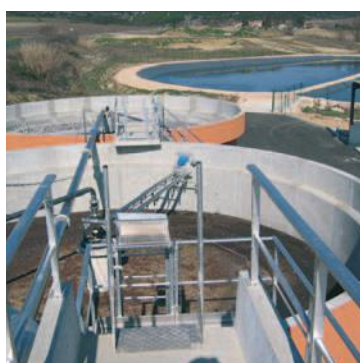
Le lombrifiltre. Au fond, la cuve de la station classique
