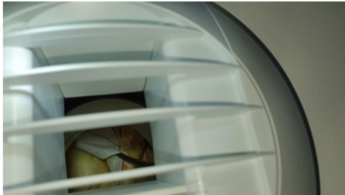
Bouche d'extraction non raccordée à une gaine
