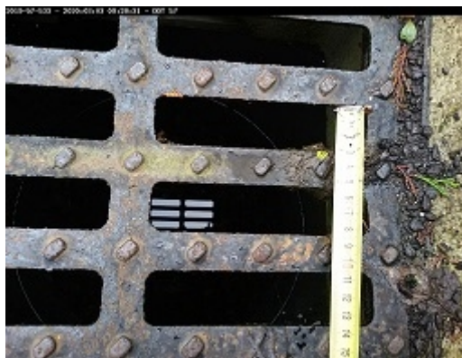
Fente de grille d'avaloir de largeur >2cm sur cheminement extérieur
