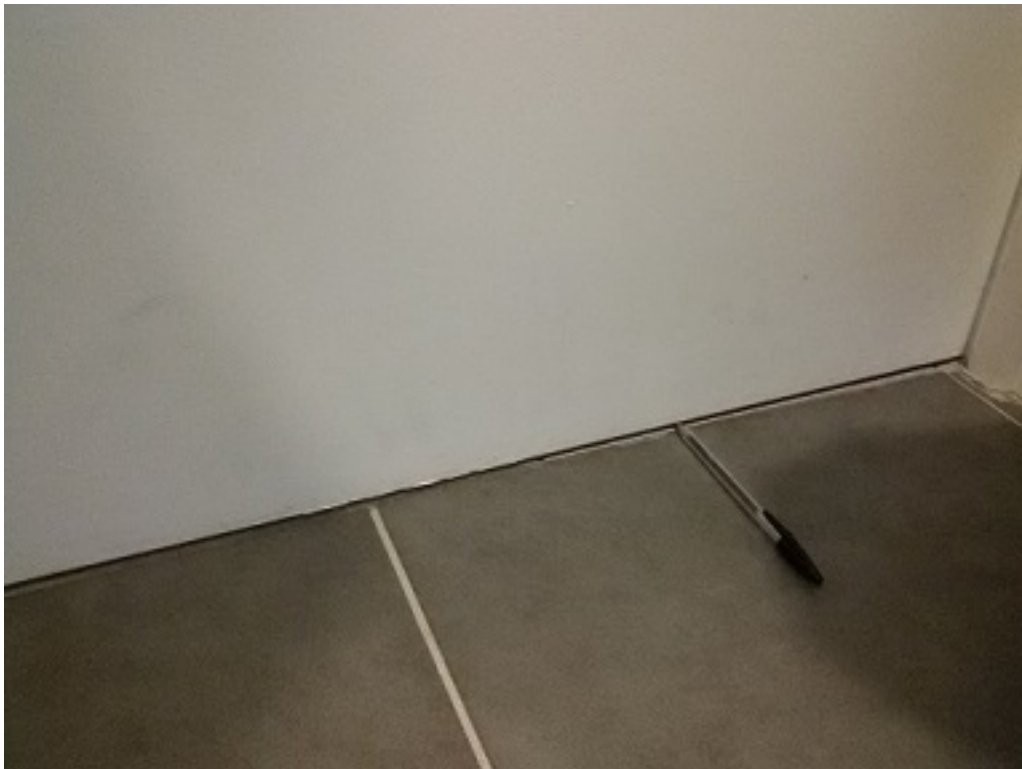
Détalonnage insuffisant de porte intérieure < 0,5cm
