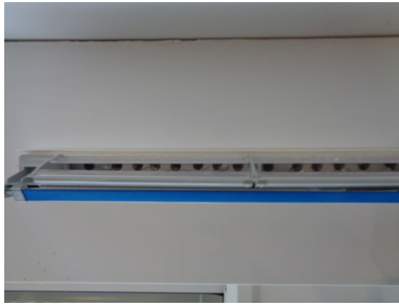
Flux d'air entrant non conforme : Mortaise aux dimensions insuffisantes pour assurer le débit d'air requis.
