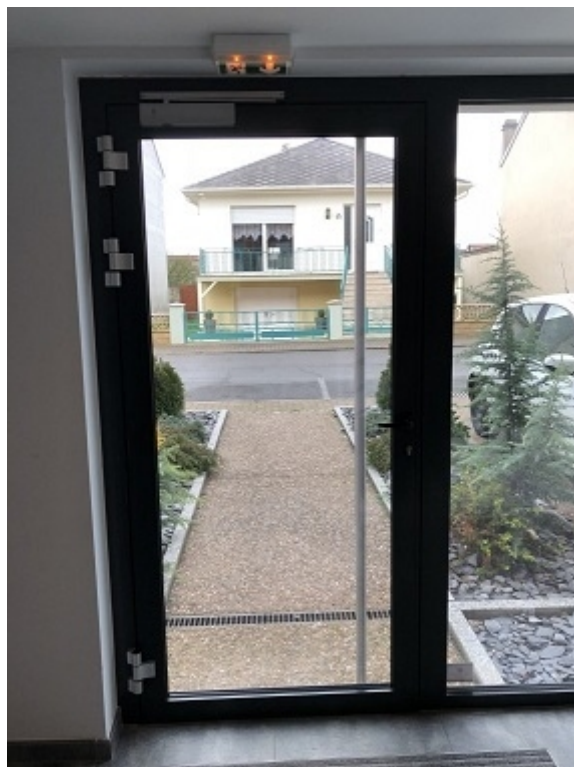
Porte d'entrée d'immeuble vitrée sans contraste visuel
