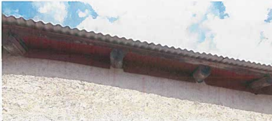
Déboord de toiture de la remise non favorable à la construction d'un nid d'Hirondelle de fenêtre
