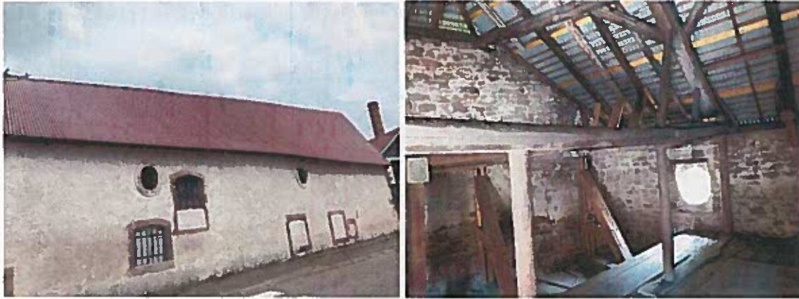
Combles de la remise avec son toit en tôles défavorable aux chiroptères
