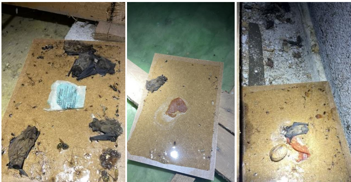
FIGURE 5 : VUE DE SEPT DES HUIT INDIVIDUS DE NOCTULE DE LEISLER MORTS DANS DES PIEGES A GLUE POUR RONGEUR, DANS LES COMBLES AU-DESSUS DE L'ATELIER ET DE LA SALLE DE TECHNOLOGIE DU COLLEGE DE GERBEVILLER (54)
