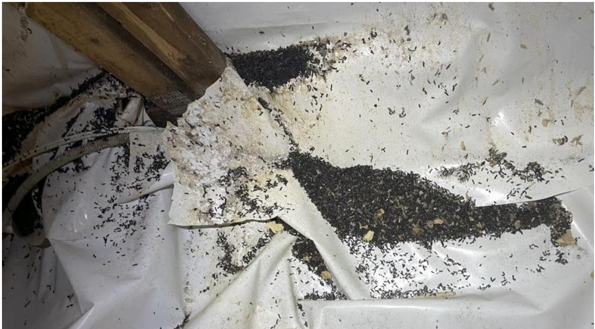
FIGURE 4 : ACCUMULATION DE DEJECTIONS (GUANO) DE NOCTULE DE LEISLER DANS LES COMBLES DE L'ATELIER ET DE LA SALLE DE TECHNOLOGIE DU COLLEGE DE GERBEVILLER (54)
