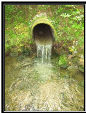
Document 40 : photo du rejet de la STEP en rive gauche, en aval du tronçon M5bis (mai 2008).
