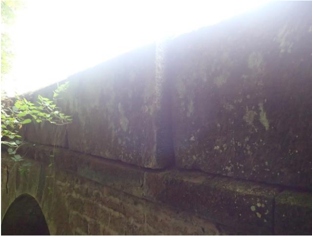
Figure 9 : Fissure sous le parapet aval du pont
