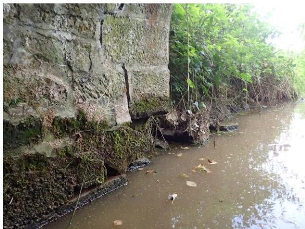
Figure 5 : Culées de pont endommagées
