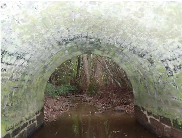
Figure 10 : Disjointement des moellons dans la voûte du pont
