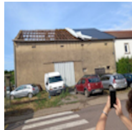
Toiture envolée à Lelling (57) le 16 juillet
