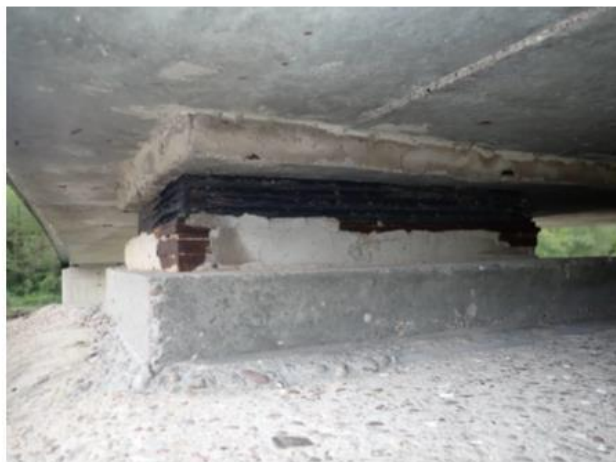
Photo n°87 : Elastomère gercé/boudiné et plaque métallique corrodée sur la pile P3
