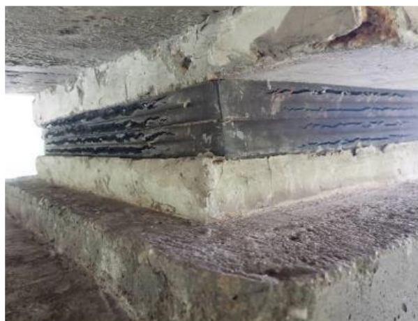
Photo n°90 : Néoprène gercé sur la pile P2
