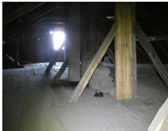
SM4BAT positionné dans le 2 ème niveau des combles. Source : ENVOL ENVIRONNEMENT
