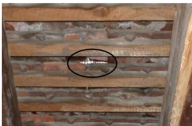
Tuiles cassées procurant une ouverture vers l'extérieur
