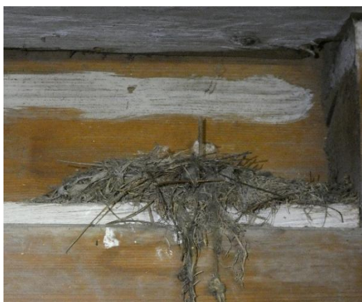
Un ancien nid sur une poutre au niveau C1.
