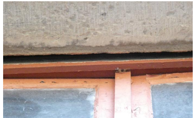
Exemple d'interstice favorable aux chauves-souris sur un encart de fenêtre façade nord.
