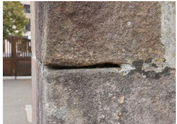
Interstice proche du sol dans un angle.
