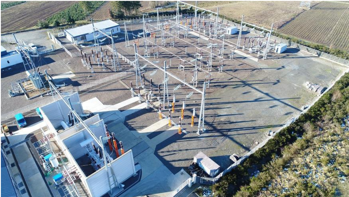
Vue d'un poste source électrique
