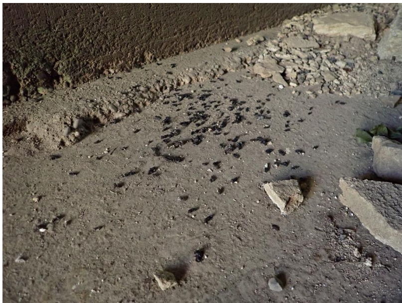
Figure 8 : guano au sol à l'aplomb d'un second disjointement
