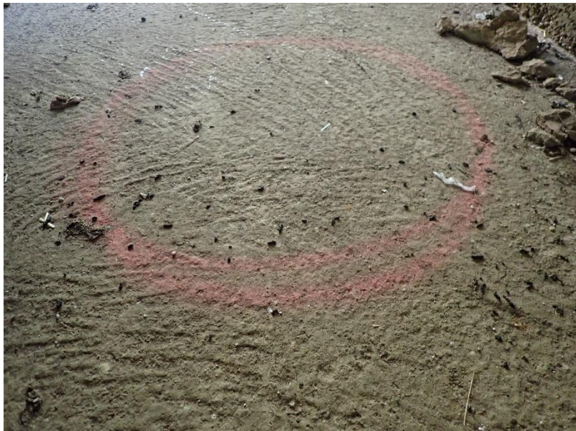
Figure 7 : guano au sol à l'aplomb d'un disjointement
