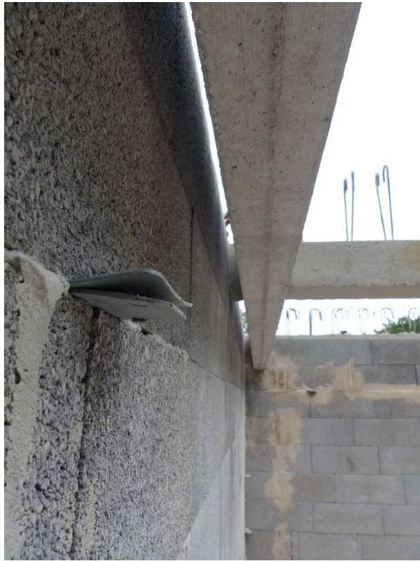
Figure 6 : exemple d'une création de disjointement le long d'un mur
