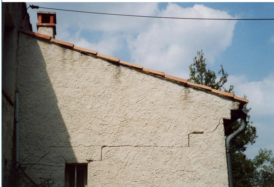
Fissuration oblique dans l'angle d'une façade (maison sinistrée dans le Var)
