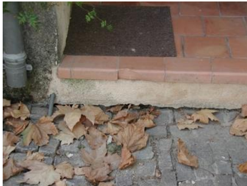
Décollement du seuil suite à l'affaissement du dallage périphérique (maison sinistrée dans les Bouches-du-Rhône)
