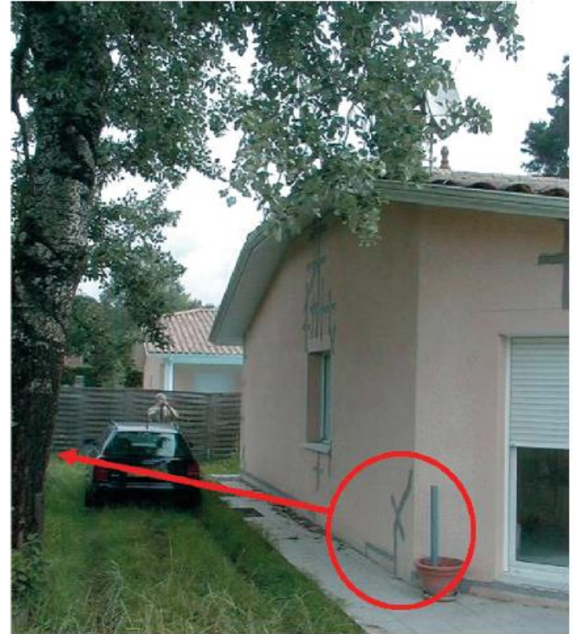
Figure 15 Fissures traitées provoquées par la présence d'un arbre (Source Socabat)
