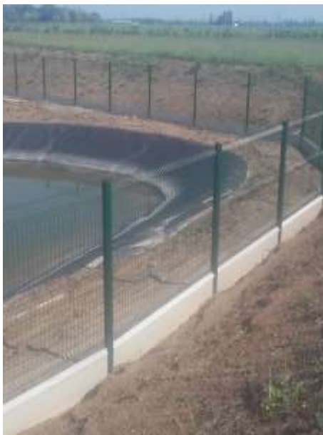
Photo 1: Exemple de clôture d'un bassin de rétention visant à interdire l'accès à la petite faune.
