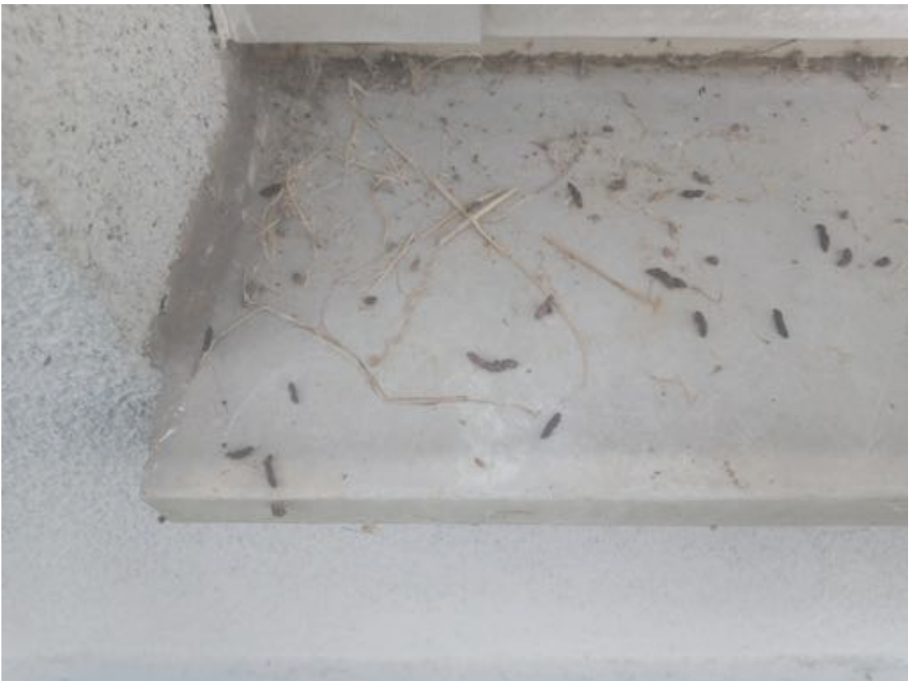
Présence de guano en bordure de fenêtre à l'IUT de Longwy.
