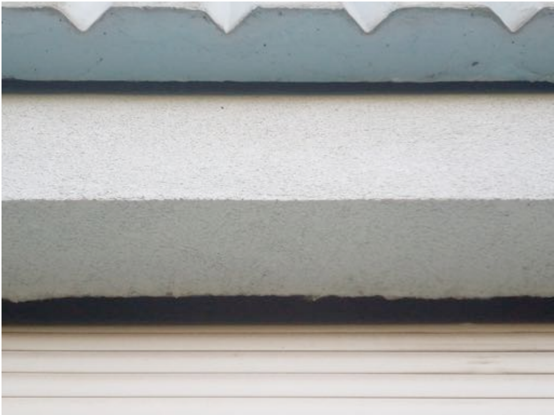
Le caisson de volet roulant ainsi que l'interstice derrière la frise en béton sont occupés par la colonie de Pipistrelle commune.
