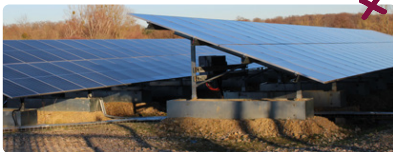
Exemple d'une implantation peu soignée, les lestages des panneaux sont posés sur un merlon de concassé en superposition du sol. Cela suggère un chantier non abouti. © Territoires & Paysages
