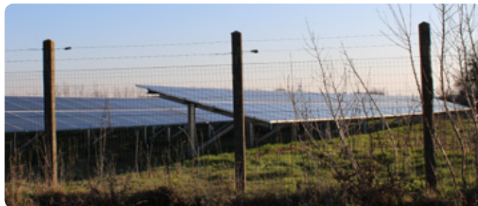
Exemple de structure porteuse en acier galvanisé au parc de Wittenheim (68) © Territoires et Paysages
