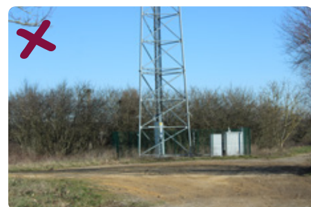
Exemples d'abords de pieds d'antennes-relais de faible qualité due à une mauvaise implantation et un choix de matériaux. © Territoires & Paysages
