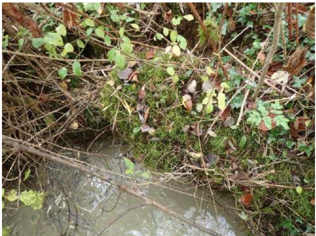
Photo 38 : tête de buse dégradée
