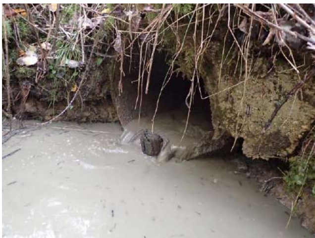
Photo 37 : buse béton - évacuation du moine
