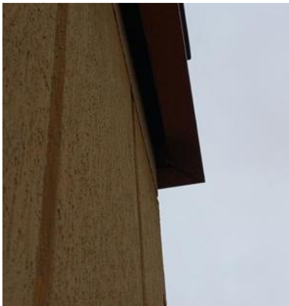
Figure 16 : Vue rapprochée des éléments métalliques supportant les nids de Rougequeue noir, © LADT, 2025
