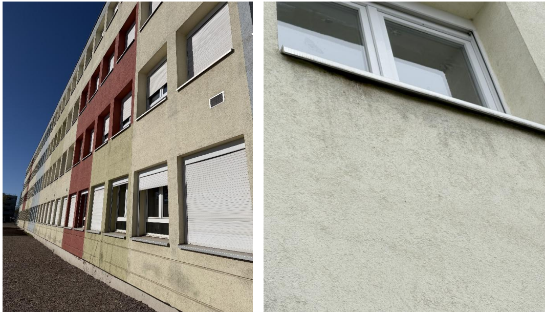
Figure 29 : Vues des tablettes de fenêtre de l’Externat (des traces liées aux fientes d’oiseau pouvant se glisser dessous sont visibles sur l’image de droite), © CPEPESC-Lorraine 2026
