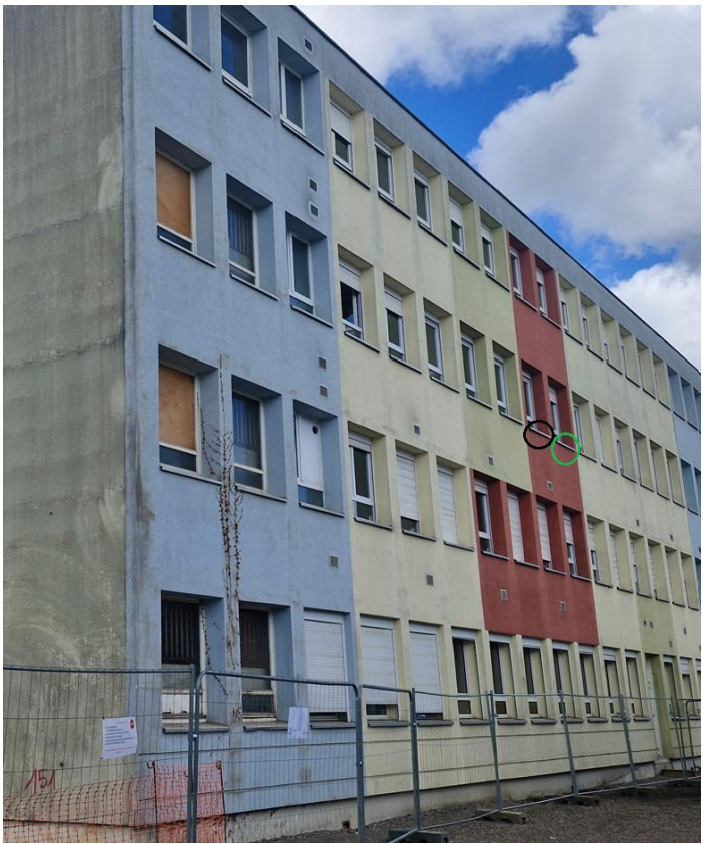
Figure 19 : Localisation des sites de nidification sur la moitié sud de la façade ouest de l’externat, © EODD, 2026
