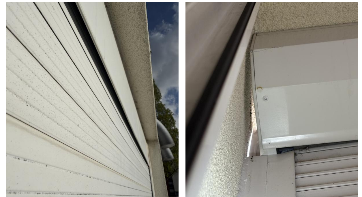
Figure 28 : Exemples d'accès vers des habitats utilisables au niveau des caissons de volets roulants, © CPEPESC-Lorraine 2026
