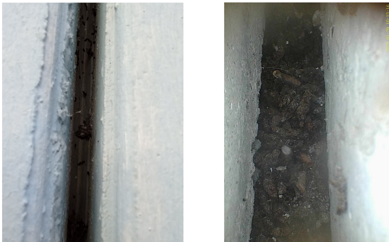
Figure 4 : Présence de guano dans les fissures (à gauche photo par téléphone, à droite photo via endoscope)
