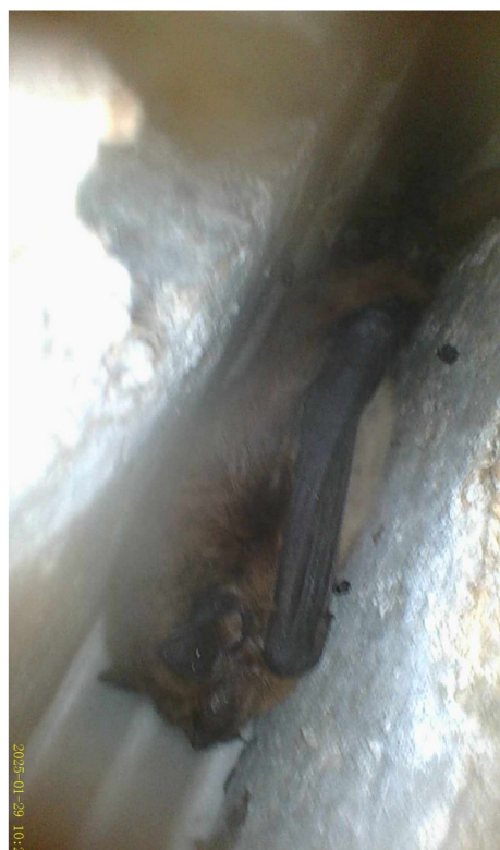
Figure 5 : Chauve-souris observée dans une fissure
