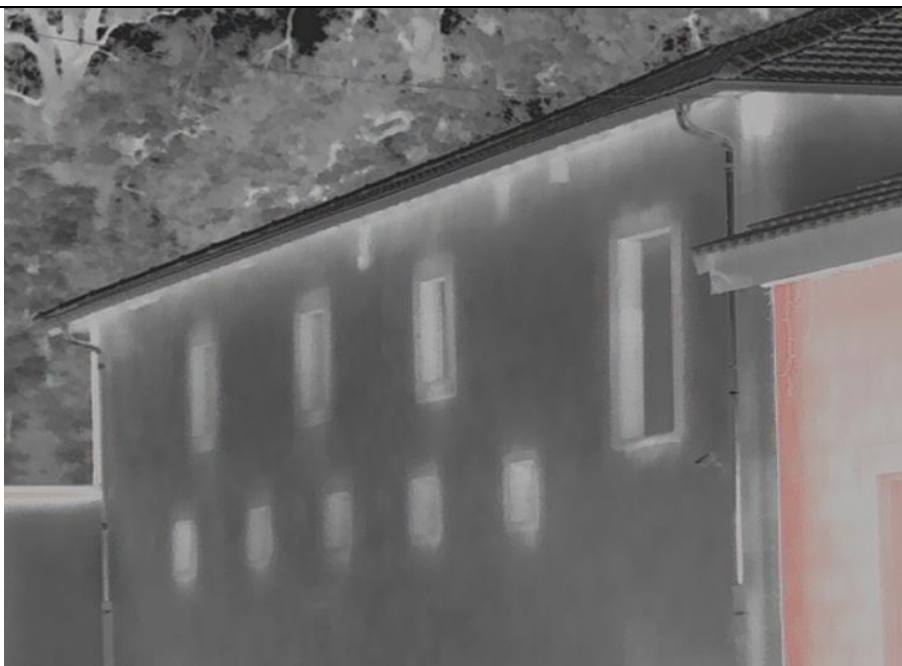
Vue de la façade sud-est à la caméra thermique
