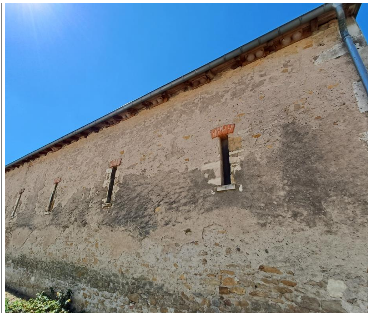
Façade sud-est avec 14 nids artificiels pour l’Hirondelle de fenêtre sur le bâtiment B002
