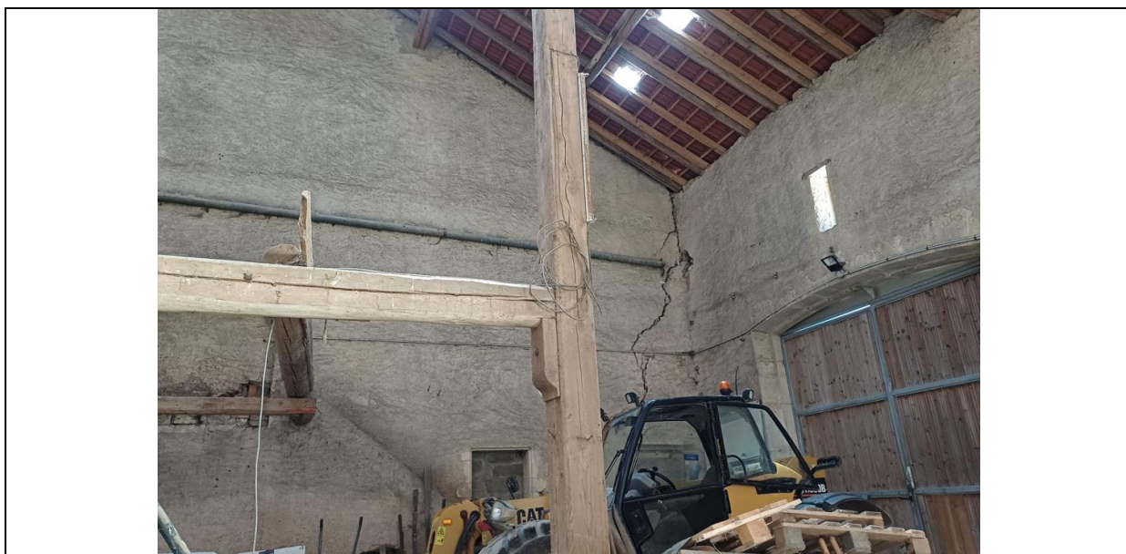
Détail de la toiture et des murs (fissures où aucun indice de présence de Chiroptères n'a été observé)
