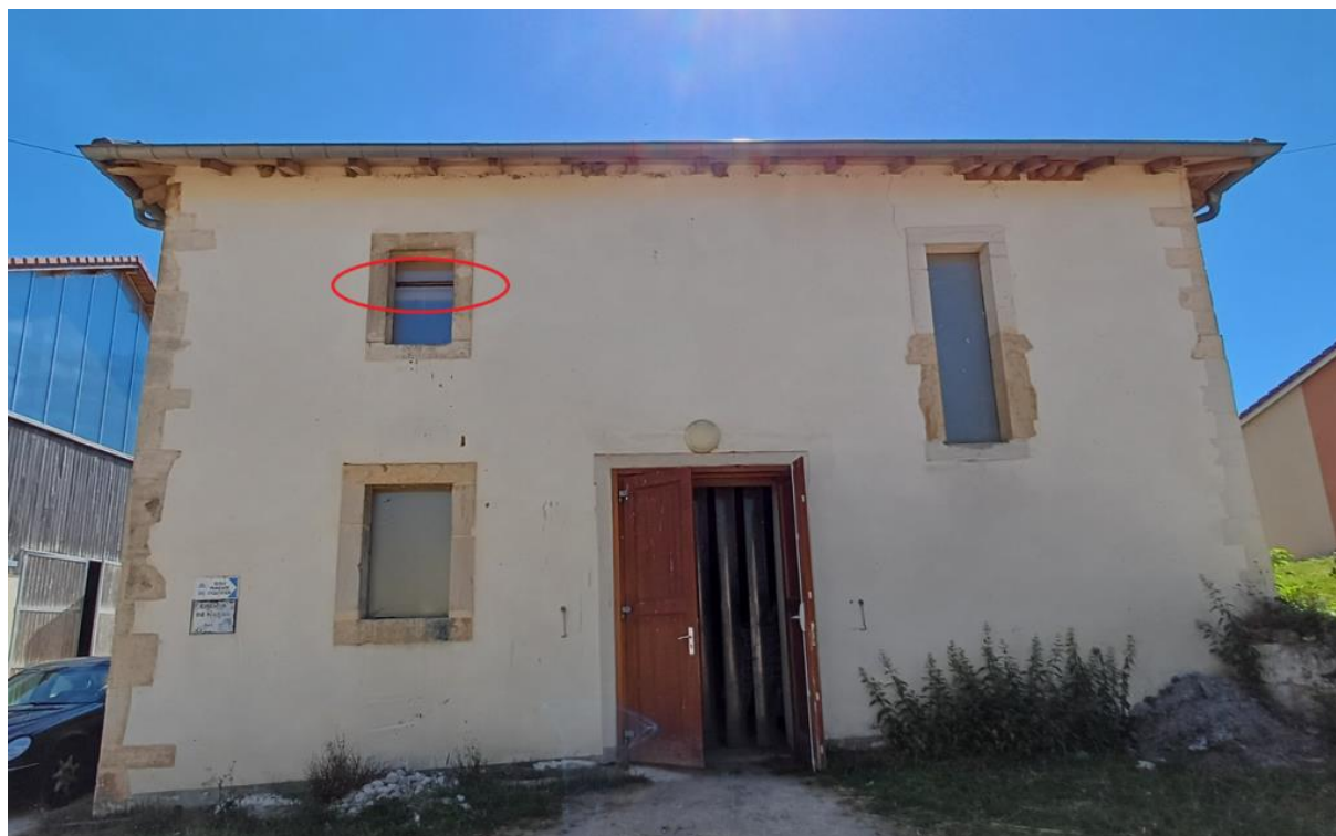
Figure 10 : Accès permanent pour les Hirondelles rustiques au sein du bâtiment B004
