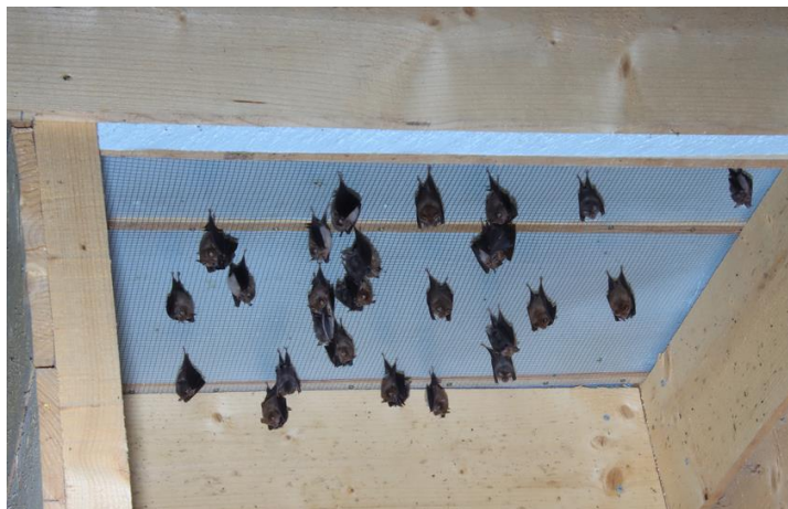
Figure 13 : Photographie du maillage fin installé au "plafond" de l'armoire à Petit Rhinolophe pour permettre leur accroche (Source : CPEPESC-Lorraine)
