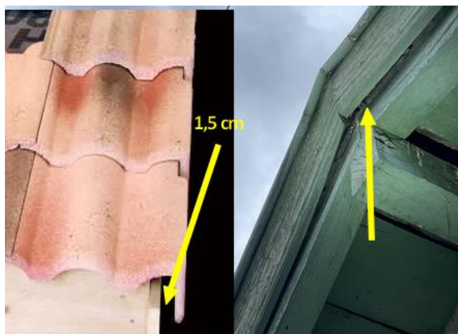
Figure 21 : Photographie d'un espace entre les tuiles de rives / rives en bois et le chevron terminal (Source : CPEPESC-Lorraine)
