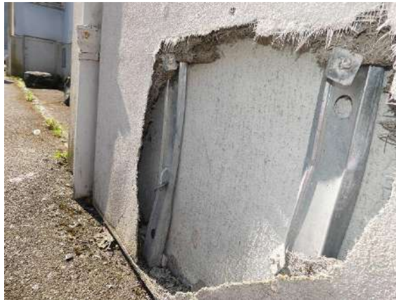
Figure 52 : Exemple de trou dans le rhabillage extérieur des bâtiments, © EODD 2024
