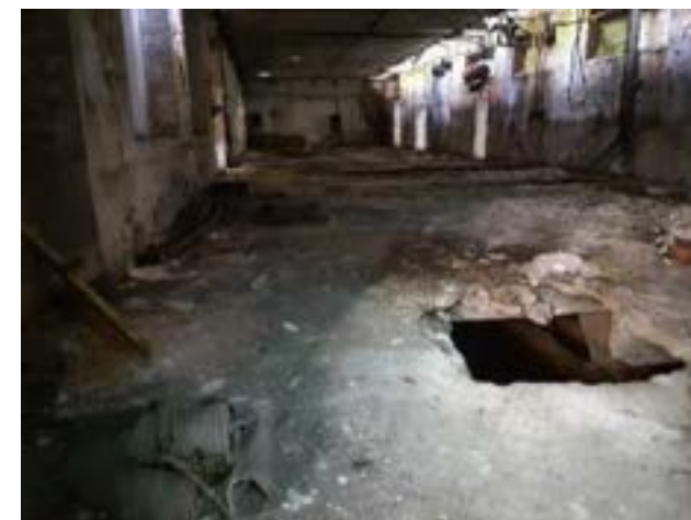
Accès sous-sol inondé
