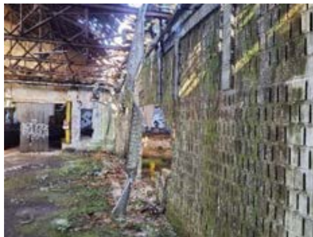
Mur parpaing en ruine / cavités potentielles
