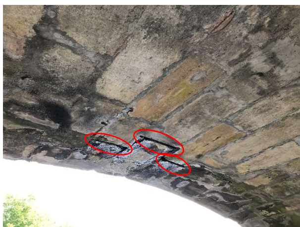
Vue sur les fissures amont de l'arche n°3 et localisation de la fissure occupée
