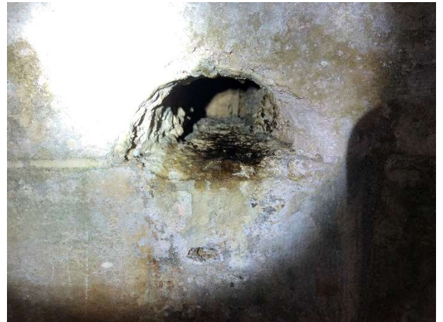
Vue sur la cavité souillée par le guano
