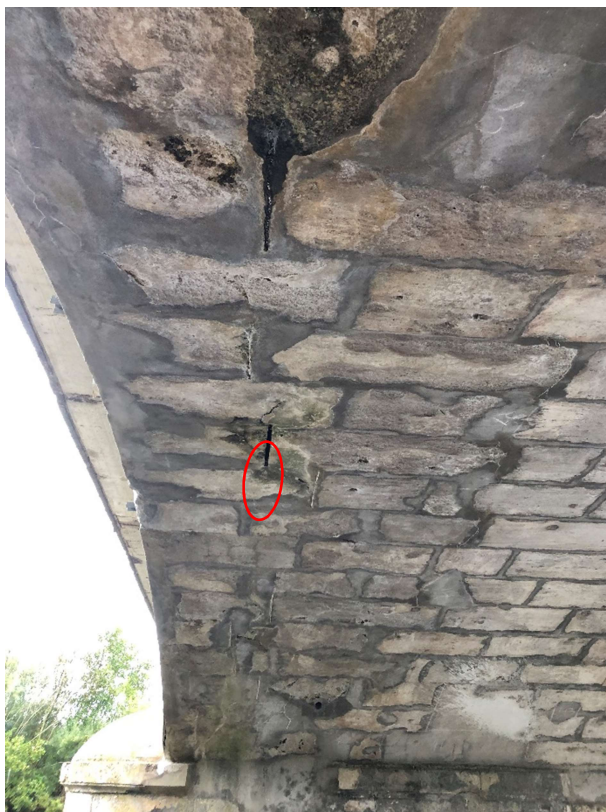
Vue sur les fissures amont de l'arche n°4 et localisation de la fissure occupée par les murins
