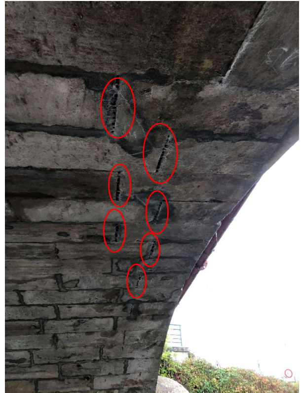
Vue sur les fissures aval de l'arche n°6
