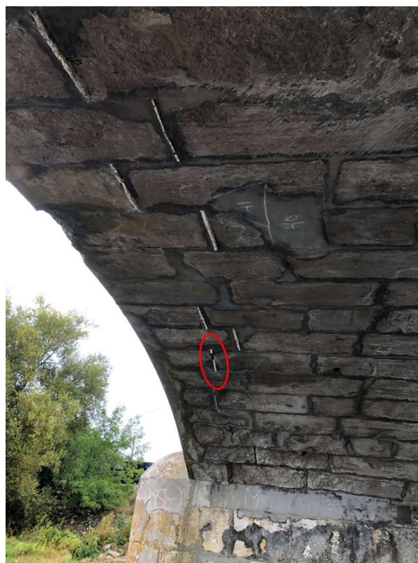
Vue sur les fissures aval de l'arche n°4 et localisation de la fissure partiellement colmatée occupée par les murins
