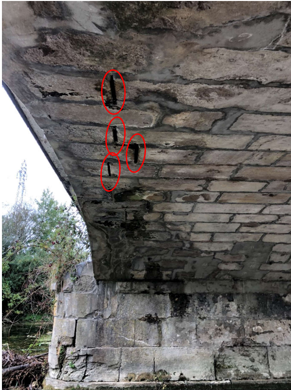
Vue sur les fissures amont de l'arche n° 5
