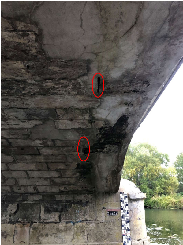
Vue sur les fissures amont de l'arche n° 7 et localisation de la fissure occupée
