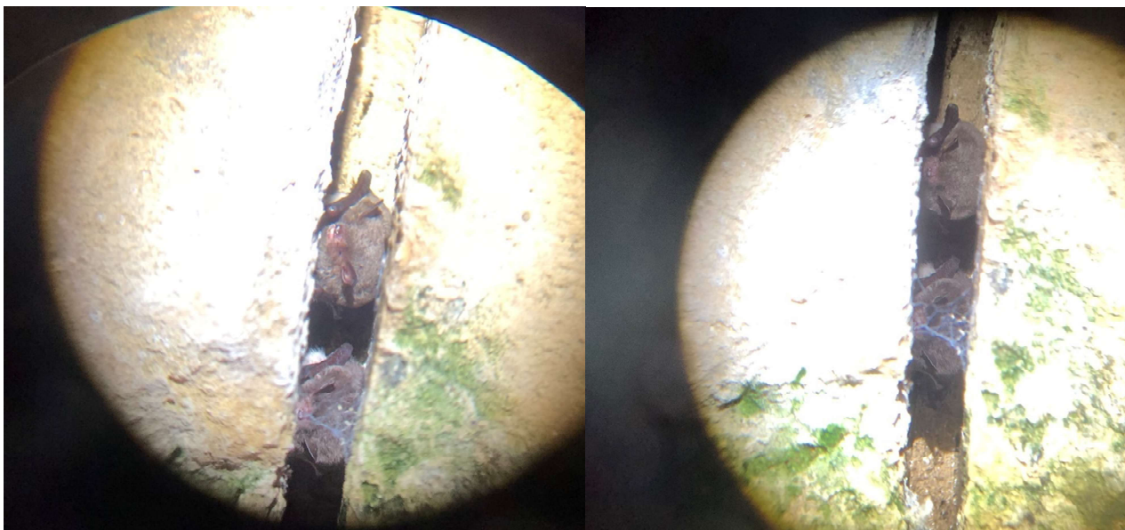
Vues sur les murins présents dans les fissures de l'arche n°4
