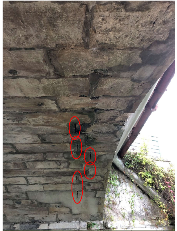
Vue sur les fissures aval de l'arche n°7 et localisation de la fissure occupée
