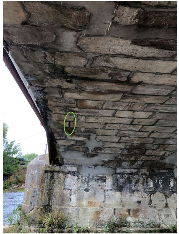
Vue sur les fissures aval dont 1 non colmatée, vide mais potentiellement intéressante
