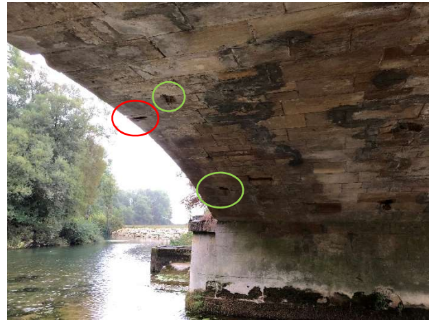
Vue sur la cavité amont occupée et sur les drains amont rive gauche et centre vides
