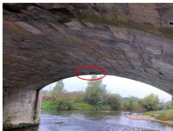
Vue sur l'aval de l'arche n°3 et localisation des fissures
