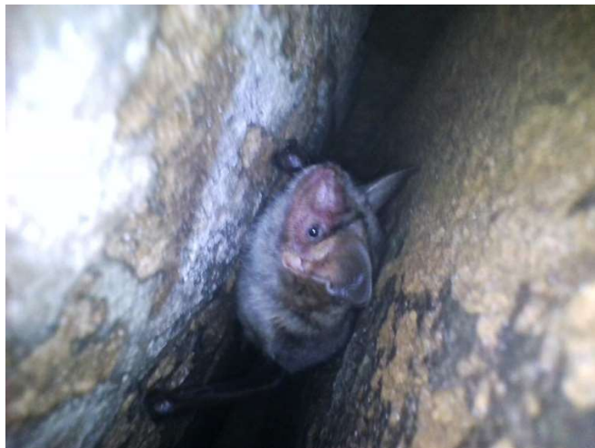
Figure 28 : Photographie de Grand murin prise le 10/08/2020 dans une fissure de l'arche n°6
