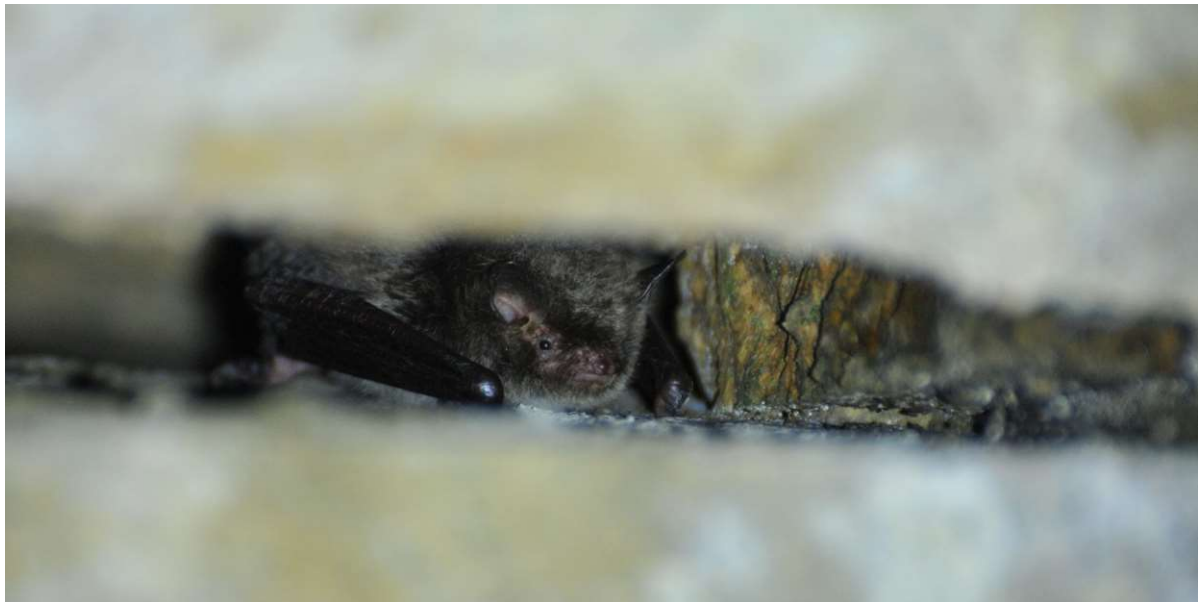
Vues sur un murin présent dans les fissures de l'arche n°5
