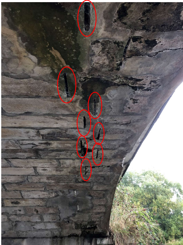
Vue sur les fissures amont de l'arche n° 6
