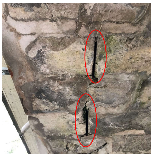
Vue sur les fissures amont
