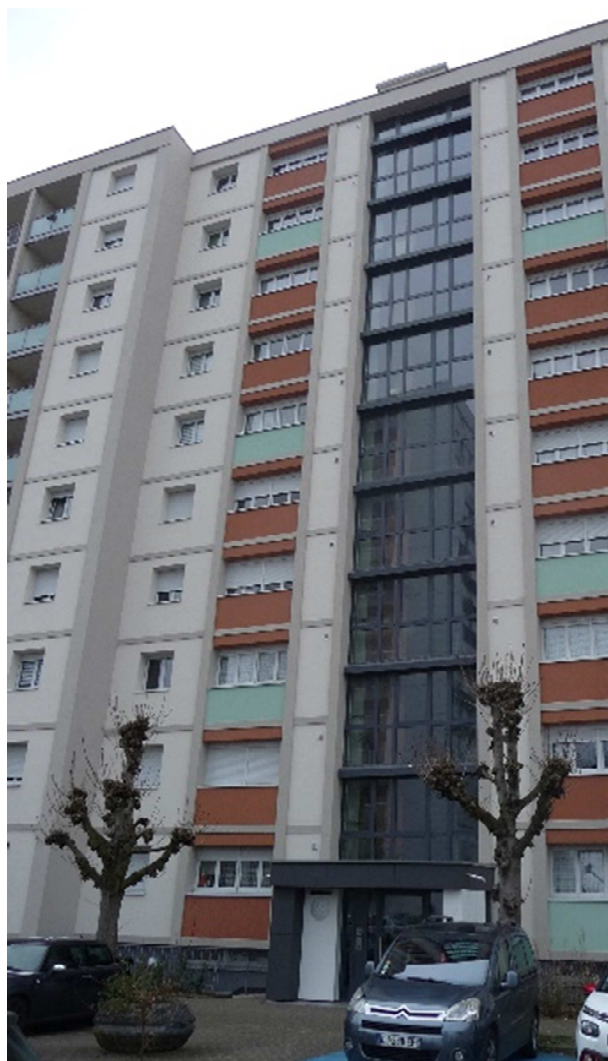
Figure 8 : traitement en façade d'une des cages d'escalier du bâtiment rue de Palerme, vue après travaux (photo Cerema).
