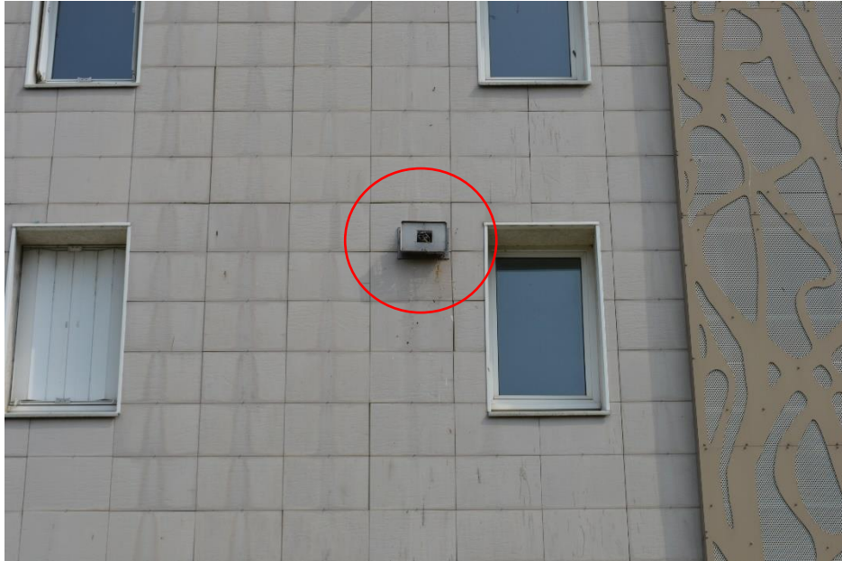
Figure 8 : Le trou indiqué sur cette grille d'aération défectueuse sur le bâtiment G accueille un site de reproduction du Moineau domestique
