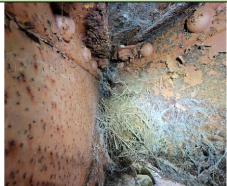
Ancien nid de Bergeronnette des ruisseaux au niveau d'une poutrelle en métal proche de la culée sud
