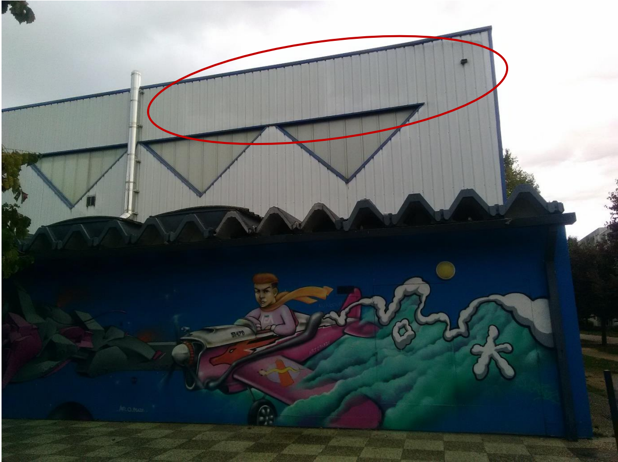
Figure 8 : emplacement envisagé pour l'installation de mesure compensatoire au niveau du gymnase (2 batteries)
