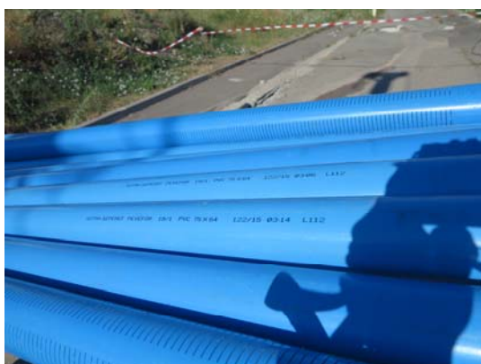
Photographie 3 – Tubes crépinés en PVC
