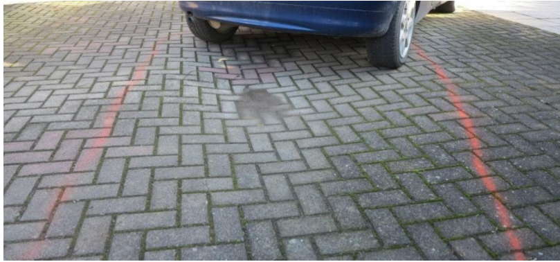
Figure 32 – Désordres aux pavés de la maison de M. Schellinger, par affaissement et gonflement localisés
