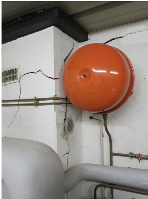
Figure 10 – Vue de l’intérieur de la chaufferie de l’habitation Schorr (décembre 2013)
