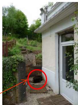
Cavité au droit du bâtiment
