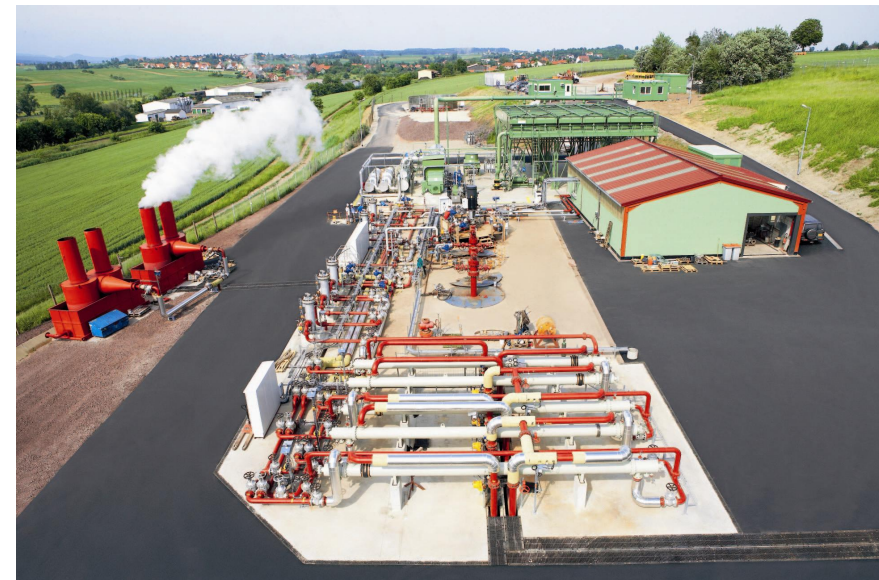
Centrale géothermique de Sultz-sous-Forêts
