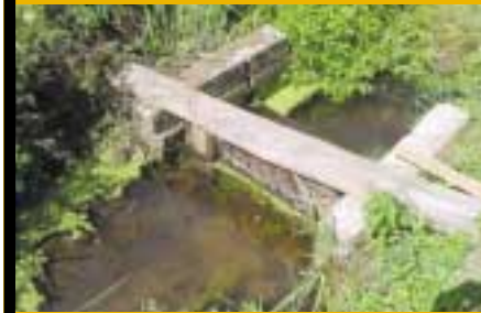
Les seuils, les barrages, ou autres ouvrages hydrauliques empêchent la libre circulation du Chabot et menacent certaines populations
