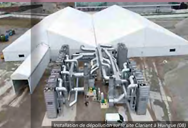
Installation de dépollution sur le site Clariant à Huingue (08)
