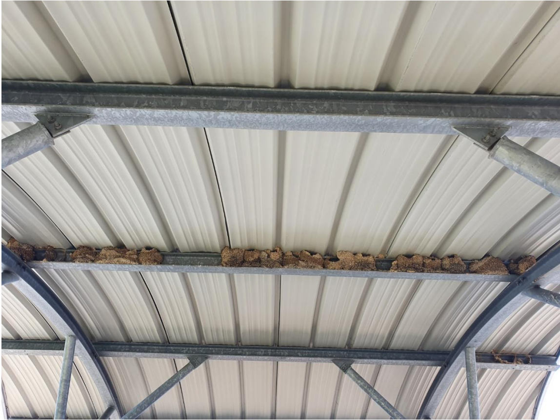
Figure 5 : Exemple de traces de nids et nids d’Hirondelle de fenêtre occupés sous les couvertures métalliques d’une des façades au n°2 rue Jean Pâche
