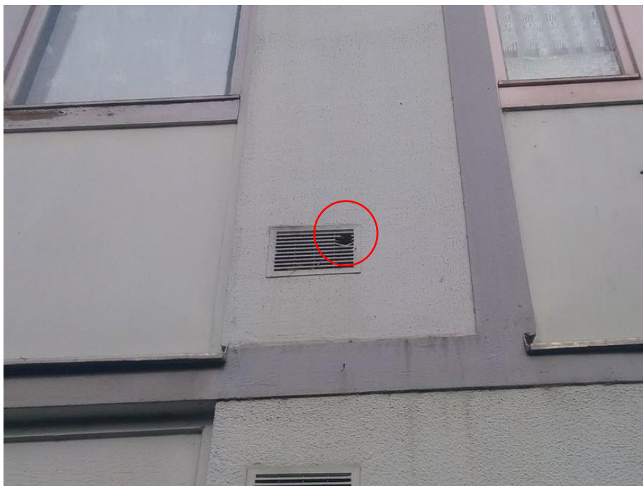
Figure 7 : Le trou indiqué sur cette grille d'aération défectueuse sur « Les Geais » est suffisant pour permettre le passage de petits passereaux
