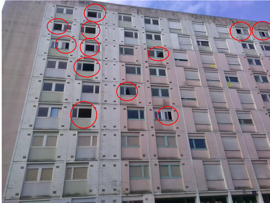
Figure 10 : Le bâtiment « Les Cygnes » présente un nombre important de fenêtres ouvertes ou brisées, permettant l'investissement des lieux par les Pigeons bisets domestiques
