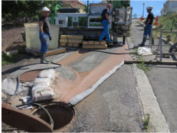
Photographie 14 – Rejet des boues de forage dans le réseau pluvial
