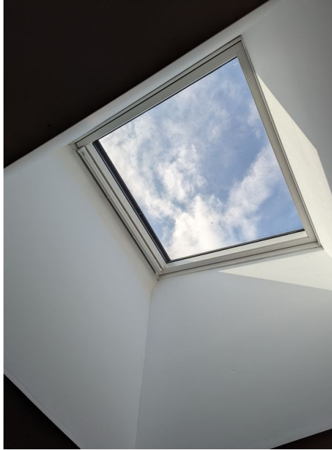
Absence de commande sur un dispositif de désenfumage
