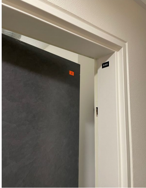
Numéro d'appartement non fixé à hauteur de vue et hors d'atteinte
