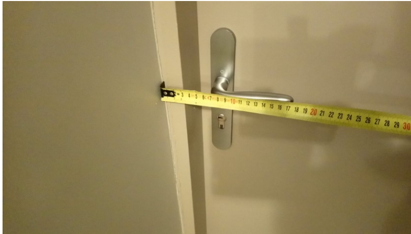
Extrémité de poignée de porte palière à moins de 40 cm d'un angle rentrant
