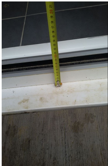
Ressaut >2cm côté extérieur entre terrasse et logement
