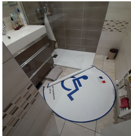
Absence d'espace de manœuvre aux dimensions suffisantes
