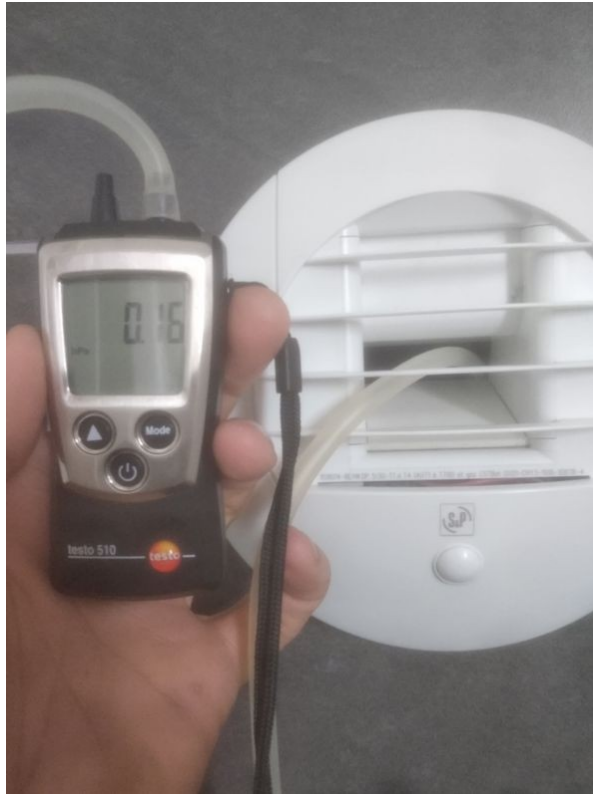
Mesure d'un débit d'air insuffisant d'une bouche VMC
