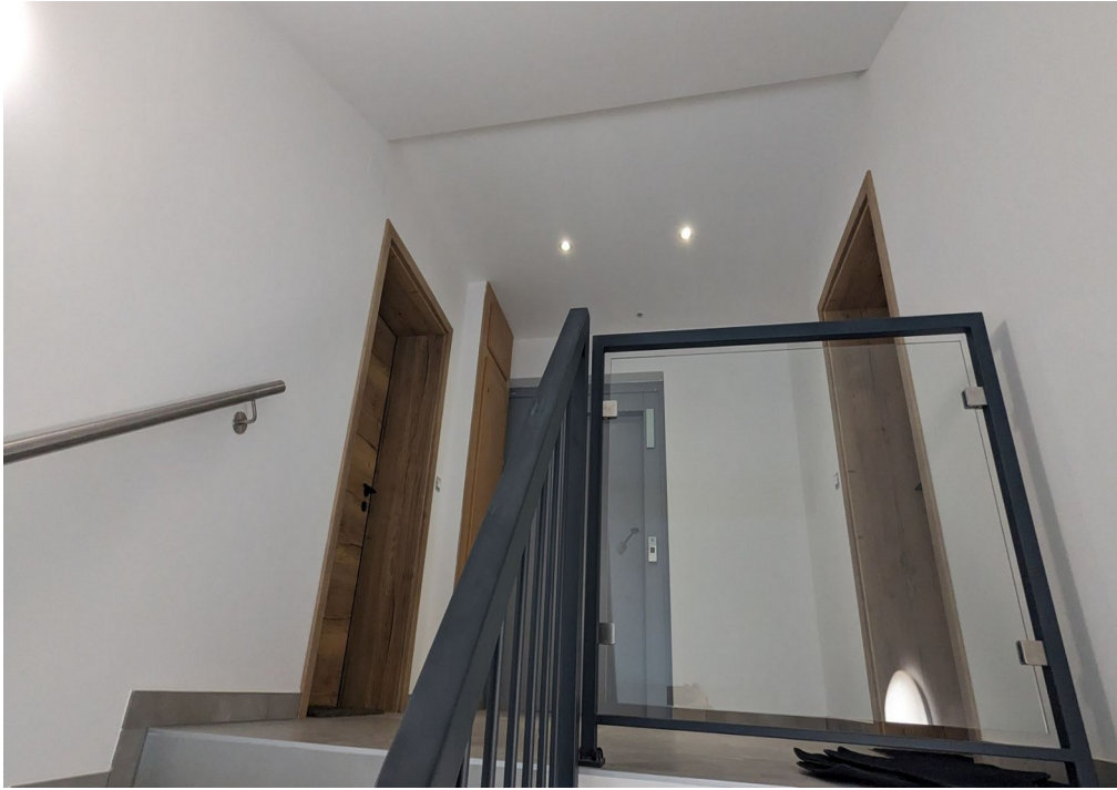
Palier haut de cage d'escalier sans désenfumage
