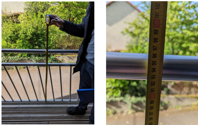
Garde-corps de hauteur insuffisante (- 40mm)
