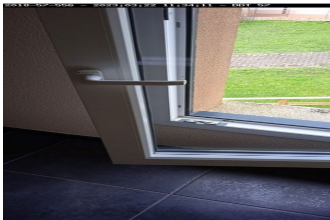
Absence de barre d'appui et d'élément de protection sur fenêtre basse.
