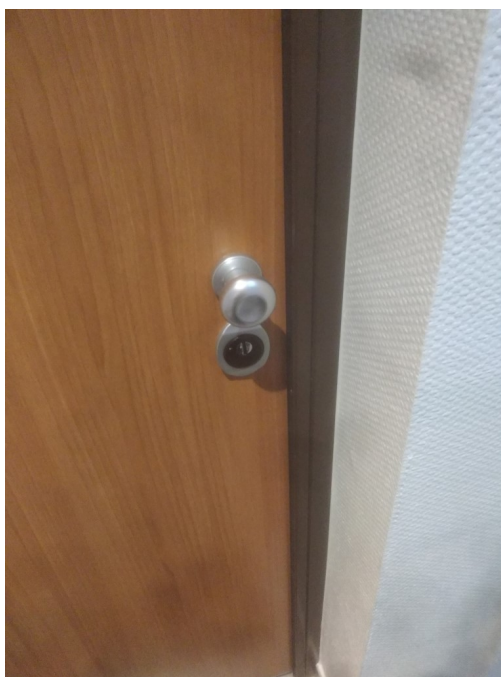
Poignée de la porte palière d'un logement difficilement manœuvrable
