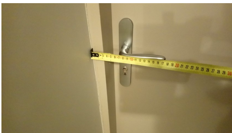
Extrémité de poignée de porte palière à moins de 40 cm d'un angle rentrant
