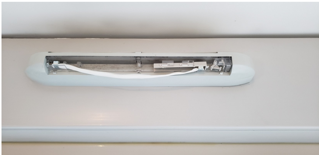
Flux d'air entrant non conforme : débit d'air requis non assuré.
