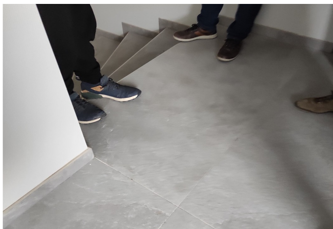
Escaliers dans les parties communes : Absence de bande d'éveil à la vigilance en haut de l'escalier.
