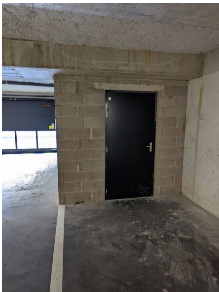
Issue sans repérage dans un parc de stationnement couvert
