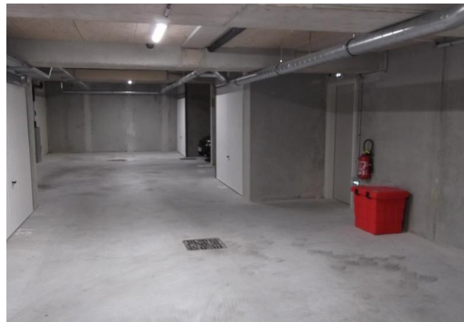
Absence partielle (ou totale) de moyens de lutte contre l'incendie dans un parc de stationnement.
