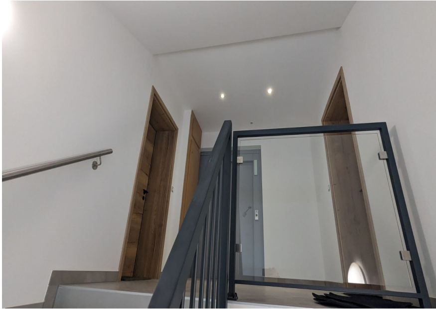
Palier haut de cage d'escalier sans désenfumage
