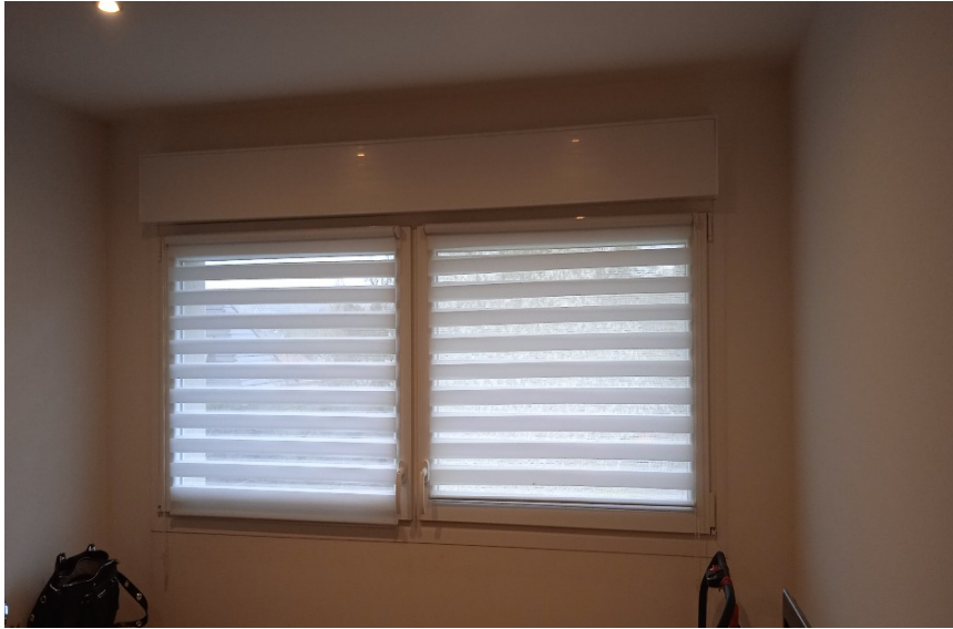
Absence d'entrée d'air dans une chambre
