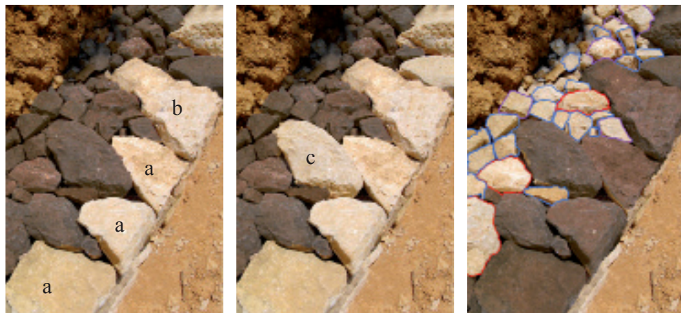
Étape 2 : mise en place des demoiselles (a), des boutisses (b) et des contre-boutisses (c)
