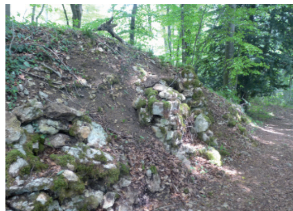
Fig III.B.2 : vue d'un mur effondré
