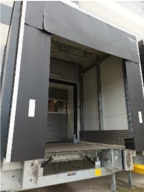
sas du niveleur de quai vue extérieure
