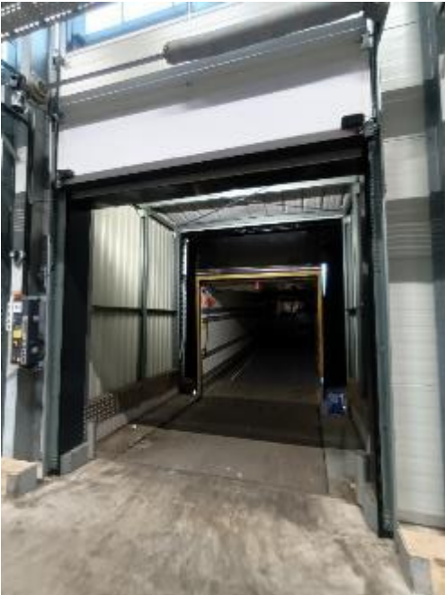
sas du niveleur de quai vue intérieure
